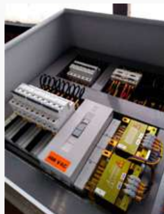
Transferencias Eléctricas Automáticas
